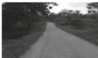
Vía lastrada en condición desfavorable
