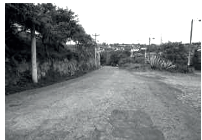
Capa de rodadura en malas condiciones.
